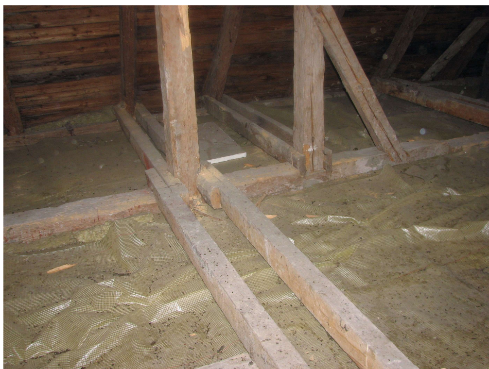
Stan techniczny kleszczy dolnych więźby nad nawą
