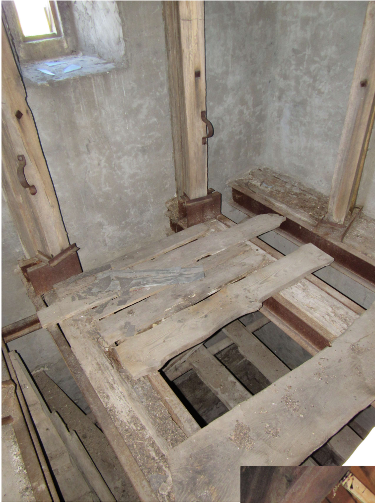
Stan techniczny stropów pośrednich w wieży.
