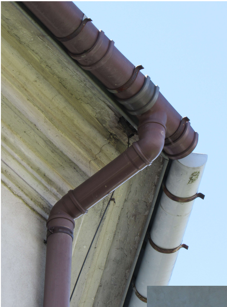
Wiszące rynny i rury spustowe z PCV, zlokalizowane po północnej stronie kościoła. Widoczny brak połączenia między rynnami.
