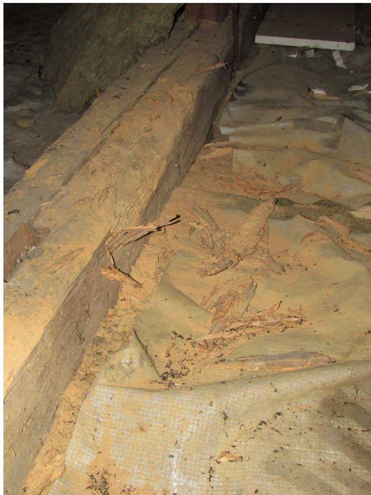
Stan techniczny belek więzaryowych/podwalin w prezbiterium
