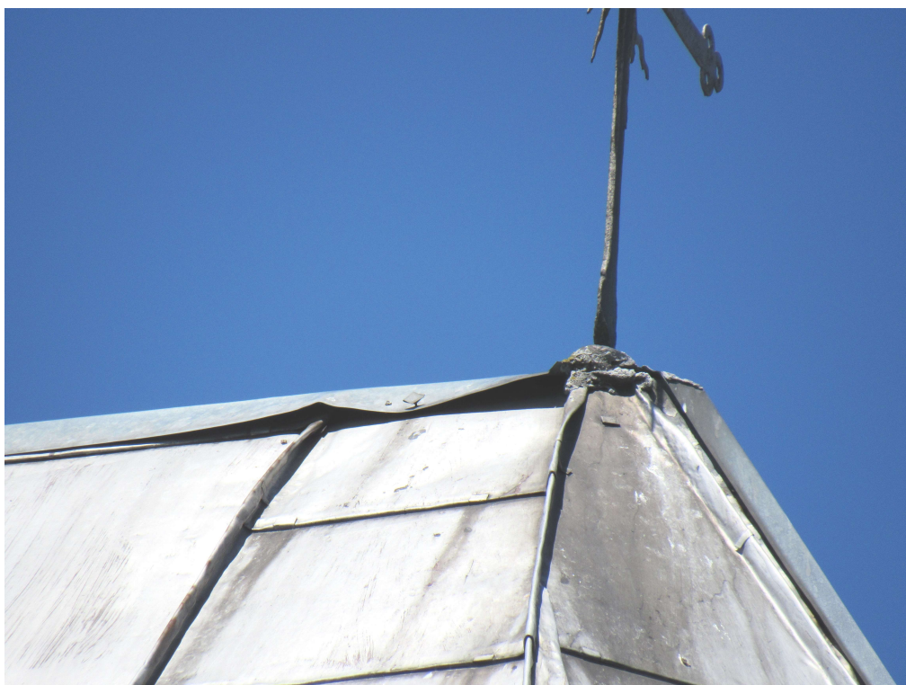
Stan techniczny obróbk blacharskich kalenicy prezbiterium.
