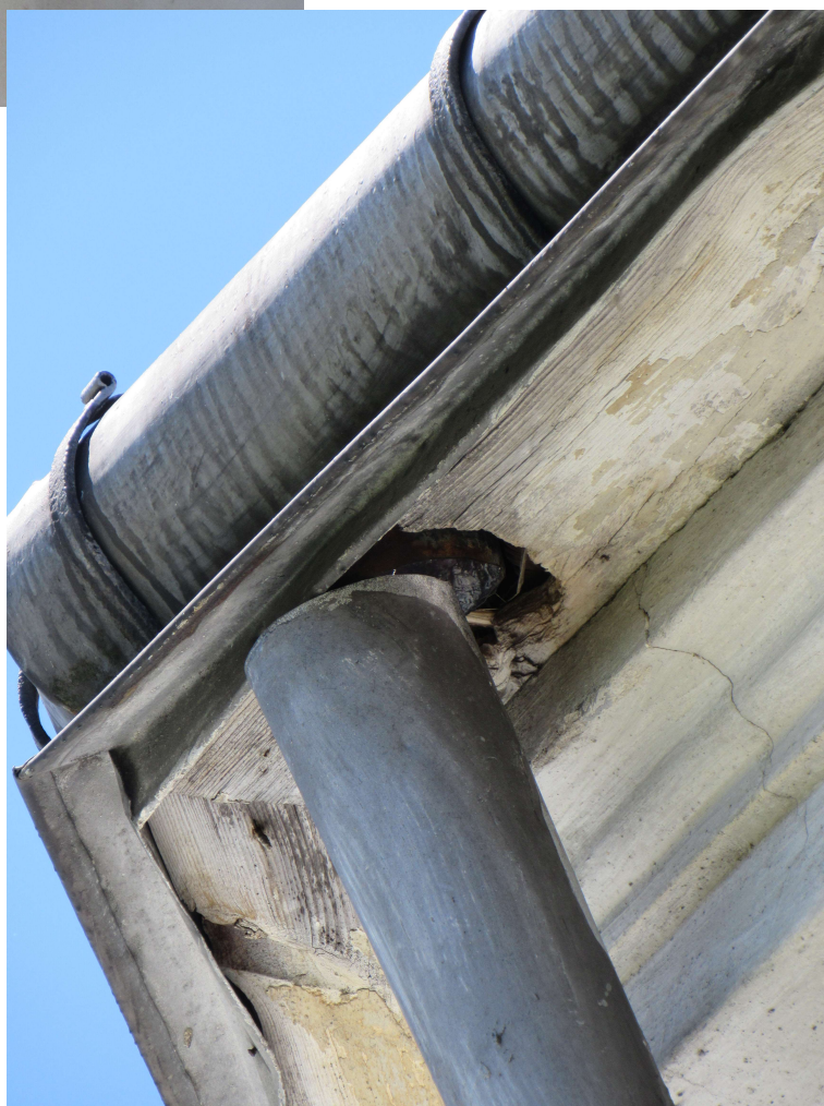
Widoczny brak odpowiedniego połączenia pomiędzy rynną leżącą a rurą spustową
