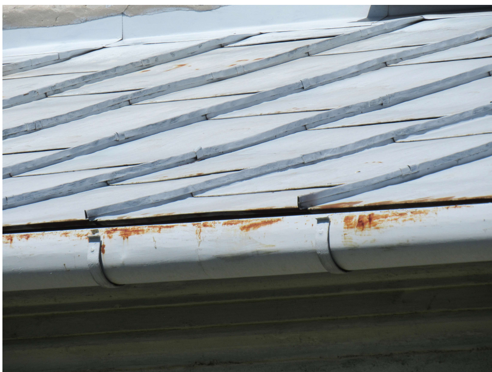
Stan pokrycia dachowego nad zakrystią. Widoczne ogniska korozji.
