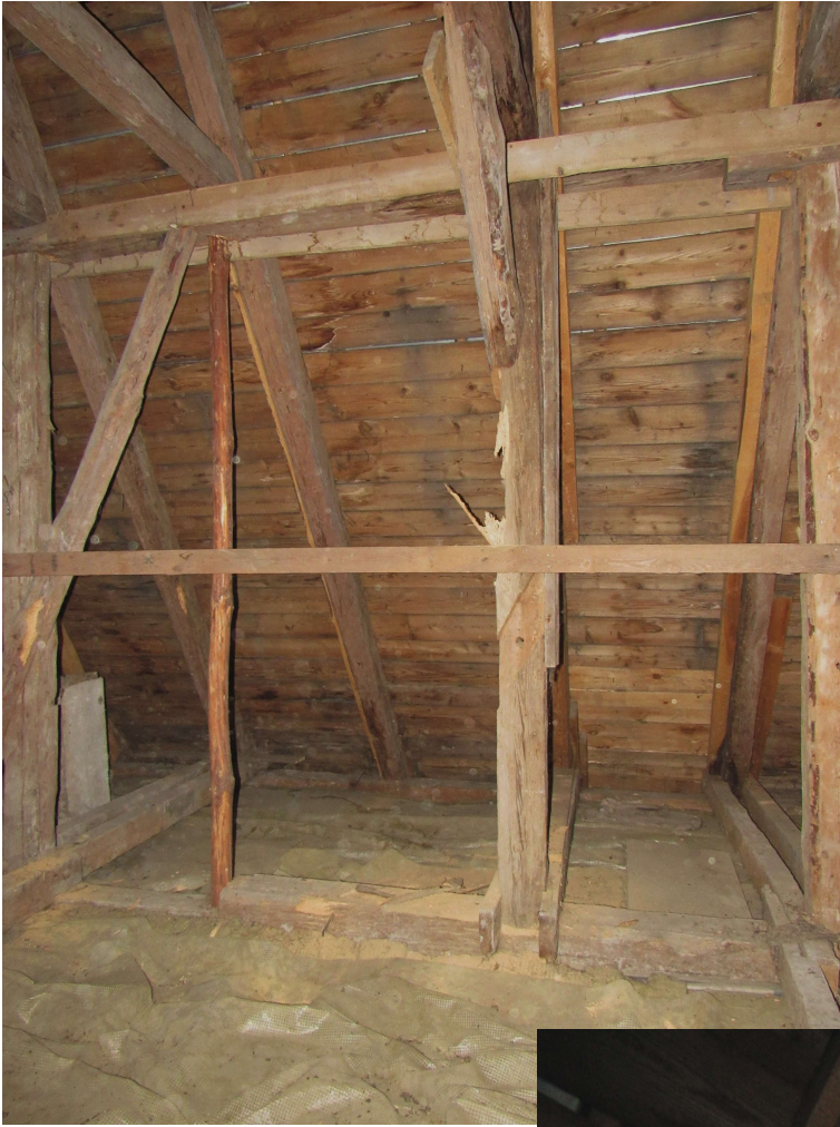
Stan techniczny słupków i podwalin
