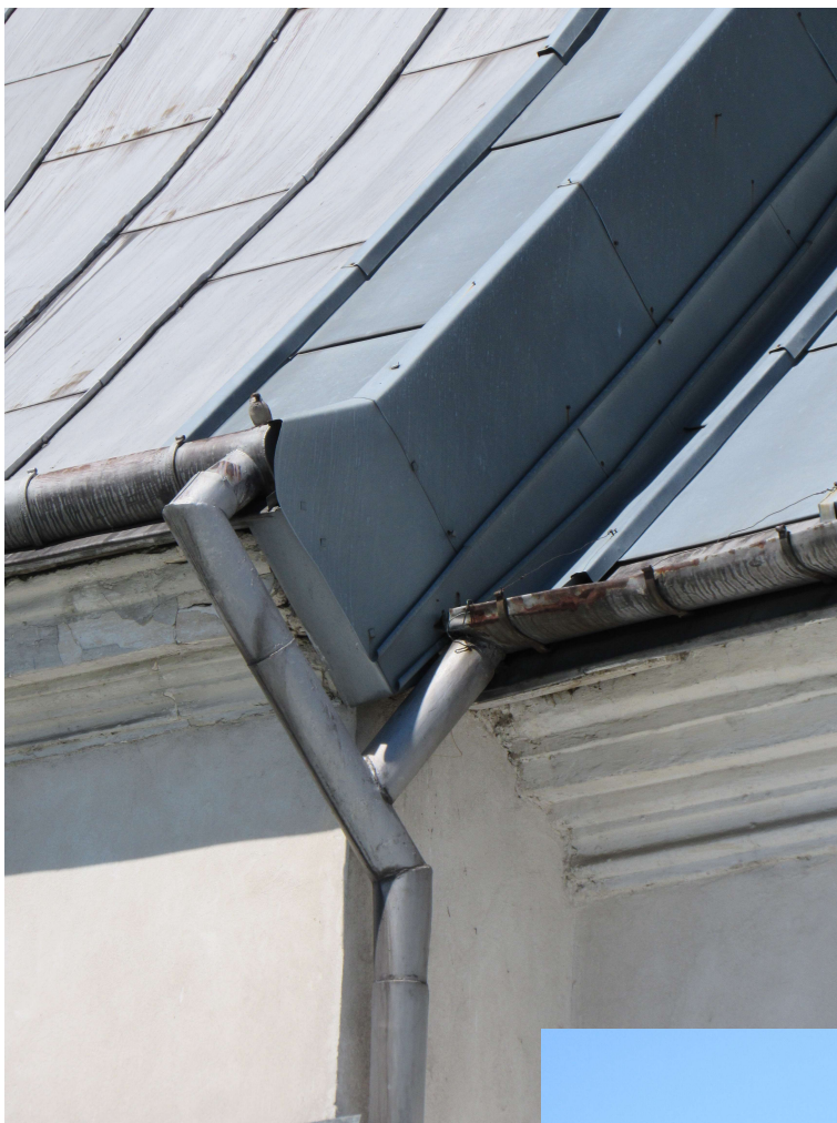
Leżące rynny stalowe na południowych połaciach nawy i prezbiterium.
