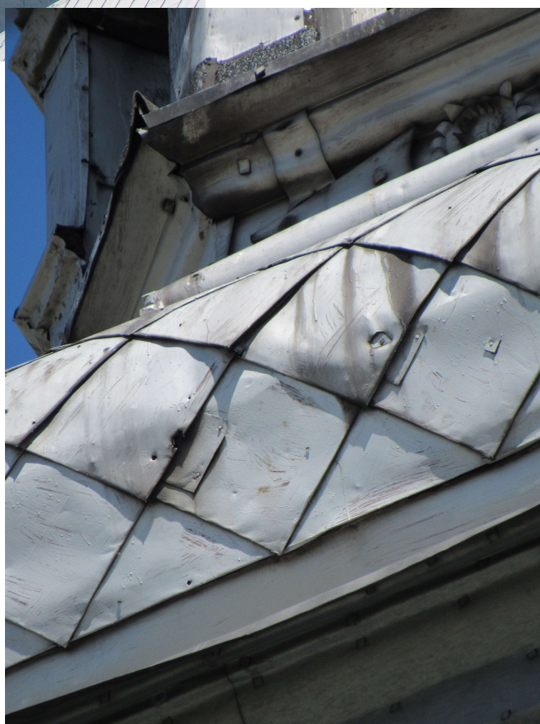
Stan techniczny pokrycia dachowego i obróbek blacharskich hełmu wieży
