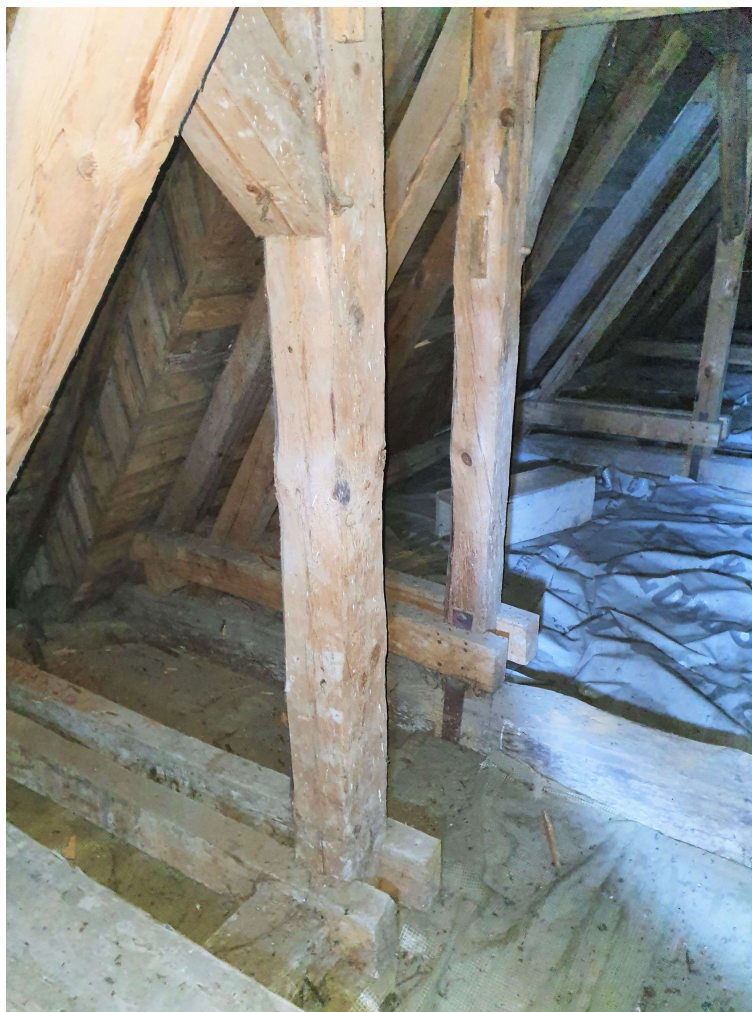
Stan techniczny kleszczy dolnych więźby na połączeniu nawy z prezbiterium
