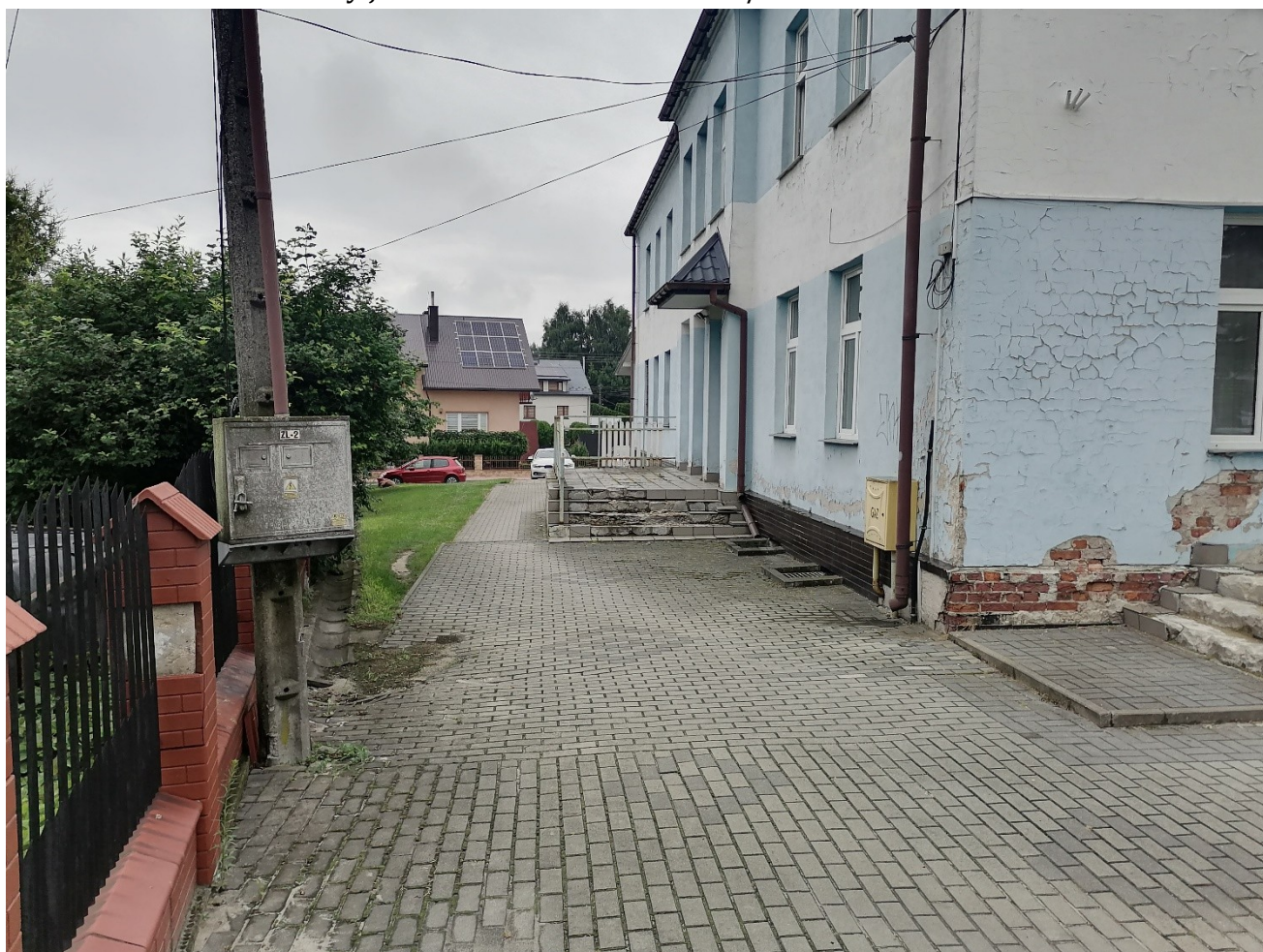
Fot. 1. Widok na północną elewację oraz część zachodniej – odspojenie wypraw tynkarskich w licu elewacji oraz płytek klinkierowych na cokole
