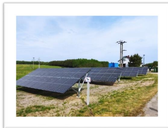
Fot. Instalacja fotowoltaiczna - Oczyszczalnia ścieków w Piotrkowicach
