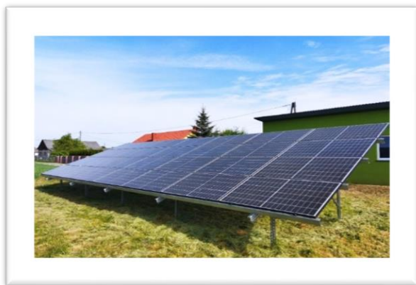
Fot. Instalacja fotowoltaiczna - stacja podnoszenia ciśnienia w Suchowoli
